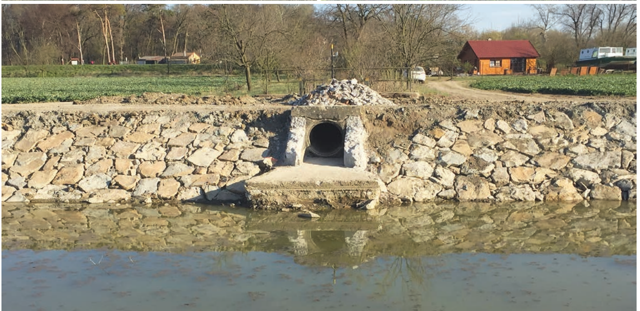
Obr. 8-6A–D Příklad lokalizace jednotlivých objektů a vybraných důležitých prvků závlahového systému v okolí Veselí nad Moravou z aktuálních terénních průzkumů (v mapě se jedná o objekty č. 3, 26, 48, 23) (foto VÚV TGM, 2021).
