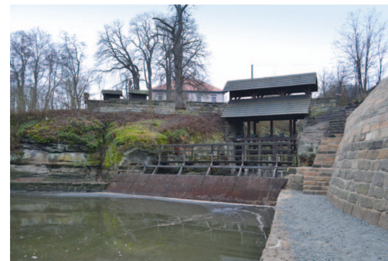
Obr. 4.63: Zahrádky, Novozámecký rybník – výpust' s otevřeným odpadem a masivní stavidlovou trámovou konstrukcí s pochozí lávkou, stříškou a česly, veškeré konstrukce jsou osazené do drážek ve skalních pískovcových stěnách. Foto Miroslav Kolka, 2015.
