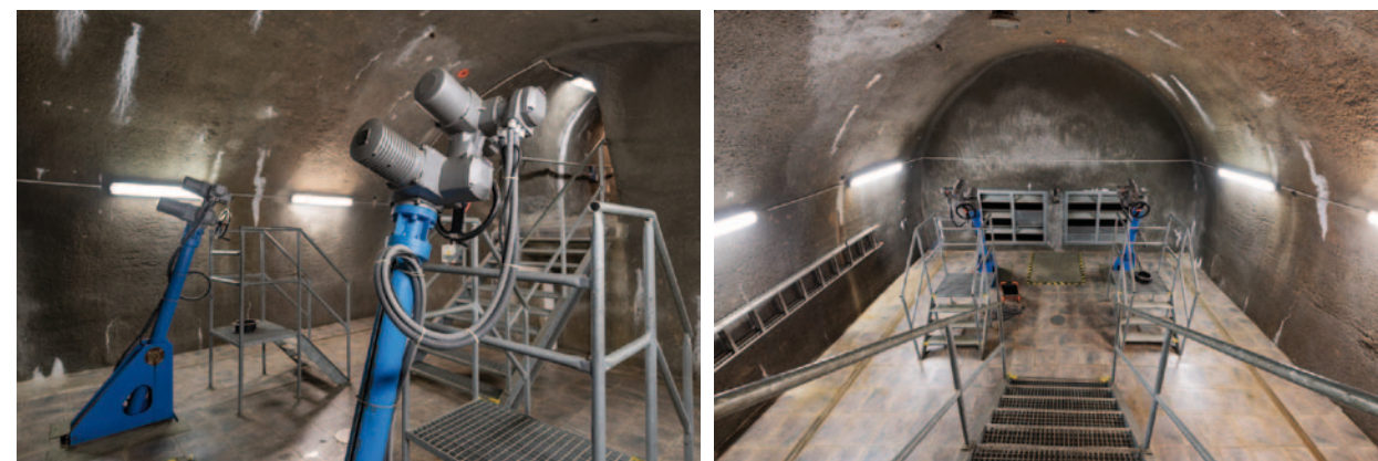
Obr. 4.10: Přehrada Pařížov (1909–1913) – ovládání provozních segmentových uzávěrů spodních výpustí DN1200 uložených v obtokové štole. Foto Viktor Mácha, 2020.
