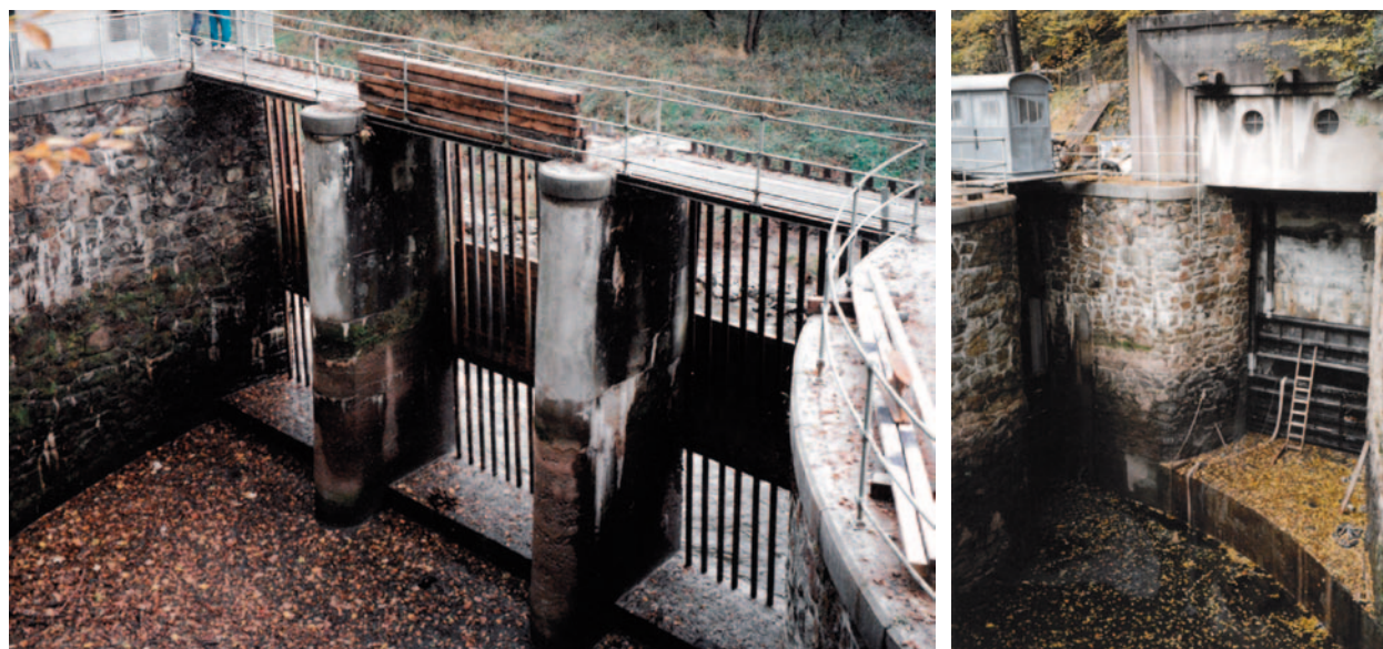
Obr. 4.143: Derivační MVE Spálov – otkový objekt, stao bez vody v době opravy v roce 1998. Foto VUT v Brně, FAST, 1998.
