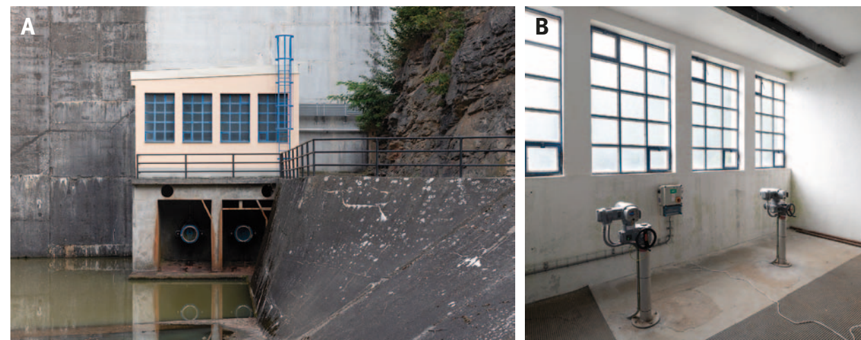
Obr. 4.24: Přehrada Vrchlice (1966–1970) – klenbová přehrada: (A) provozní rozstříkací uzávěry spodních výpustí; (B) ovládací zařízení rozstříkacích uzávěru. Foto Viktor Mácha, 2020.
