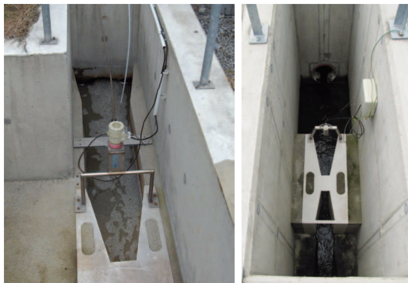
Obr. 4.255: Parshallův žlab. Foto archiv VÚV.
