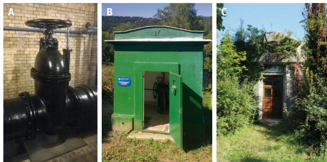
Obr. 3.3: 1. březovský vodovod: (A) manipulační uzávěr vody; (B) šoupátková komora; (C) vstup do zemního vodojemu Holé hory 2; litinový dálkový přiváděč pitné vody o délce 57 km, který se zachoval v původním provedení, vyjma modernizace dálkového ovládní strojního vybavení. Foto David Honek, 2019.
