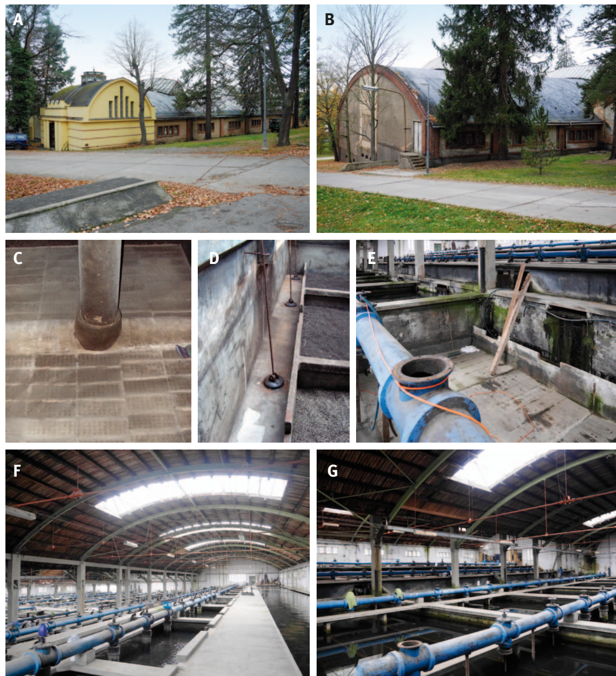
Obr. 5.20: Plzeň – budova Puech-Chabalovy filtrace: (A) hlavní vstup a nejužší položená severovýchodní hala; (B) nejnižší položená jihozápadní hala; (C) – (E) čištění jednotlivých nádrží; (F) a (G) haly za současného provozu. Foto (C) a (D) Jan Mikač, 2015; (A), (B), (E) – (G) Michaela Ryšková, 2020.
