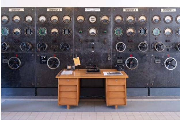
Obr. 4-3 Poděbrady, vodní elektrárna. V rámci modernizace došlo k výměně převodů, generátorů a řídicích mechanismů. Původní řídicí pracoviště zůstalo po ukončení provozu zachováno na místě (foto Viktor Mácha, 2019).
