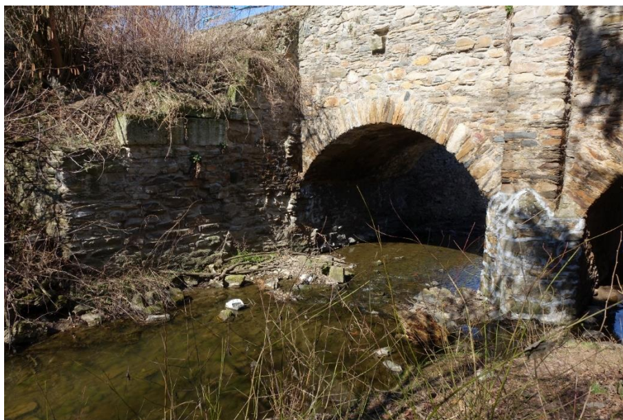
Obr. 29 Kamenný most vystavěný po roce 1861, nad bývalým splavem z rybníka Svornost, včetně relikvů zpevněných boků splavu (návodní strana hráze, foto: J. Frajer, 2022)
