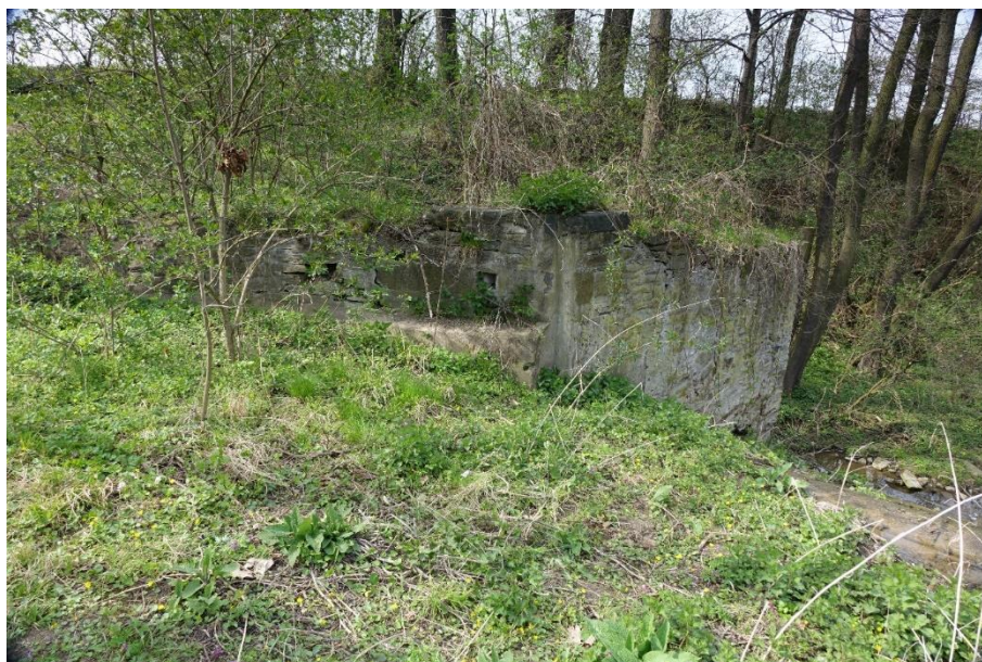
Obr. 17 Splav z rybníka Trubného. Vpravo protékaná část, vlevo původní dno rybníka s opevněním hráze a viditelnými otvory pro nosníky dřevěných prvků – lávky nebo stavidel. (foto: J. Frajer)
