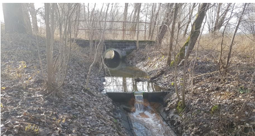
Obr. 6.7 - Vodoměrný profil s online záznamovým zařízením na přítoku do Nesvačilského rybníka – podzim 2022
