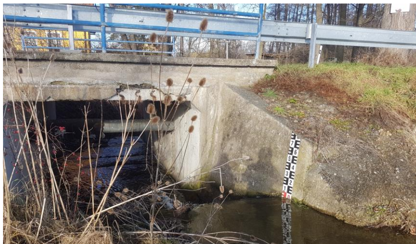
Obr. 6.13 – Funkční objekt bezpečnostní přeliv na Nesvačilském rybníku
